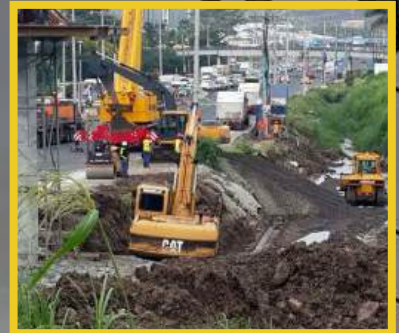
02- Equipos y Maquinarias
